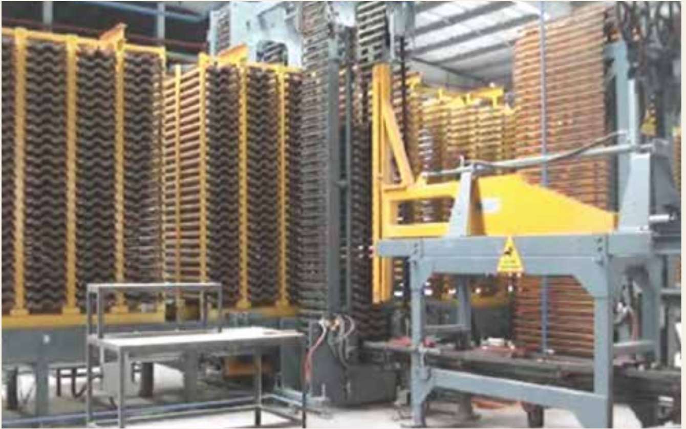
Hệ thống xếp ngói hoàn toàn tự động:
